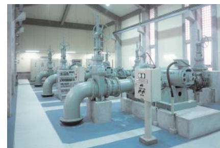
雨水排水施設
