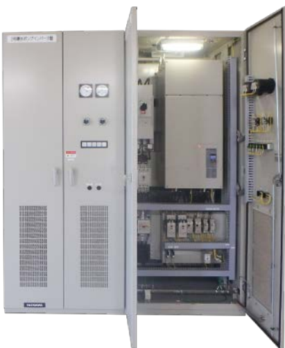
可変速ドライブ用インバータ盤
