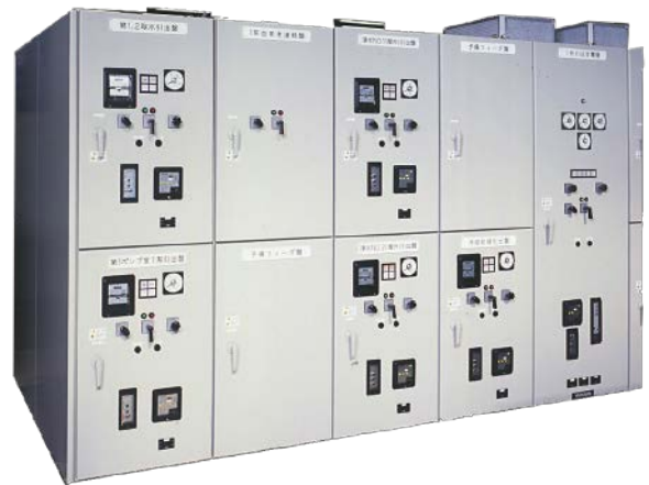
高圧閉鎖配電盤
