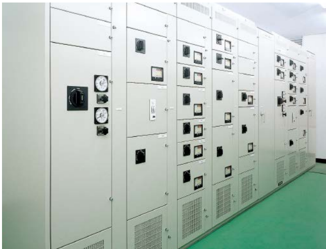
コントロールセンタ・リレー盤
